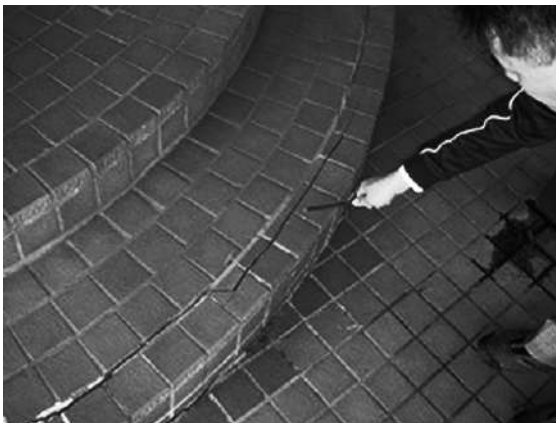
研究棟入口階段の亀裂
