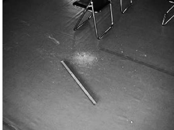
体育館天井からの落下部材
