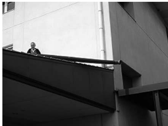
研修棟雨樋の損傷
